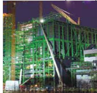
Eesti Energia 300MW power plant
